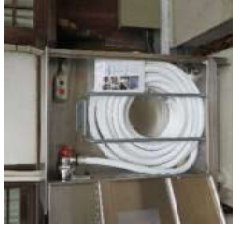
（易操作性1号消火栓）
