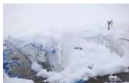
被災した特用林産振興施設
