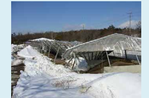
・積雪による堆肥生産施設の倒壊
