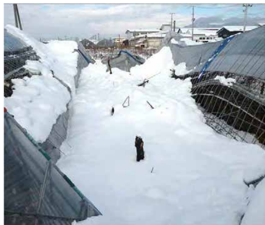
補強未対策によるハウスの倒壊
