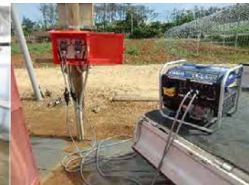
非常用電源の導入 （共同利用）
