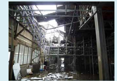
・積雪による選果場屋根の損傷
